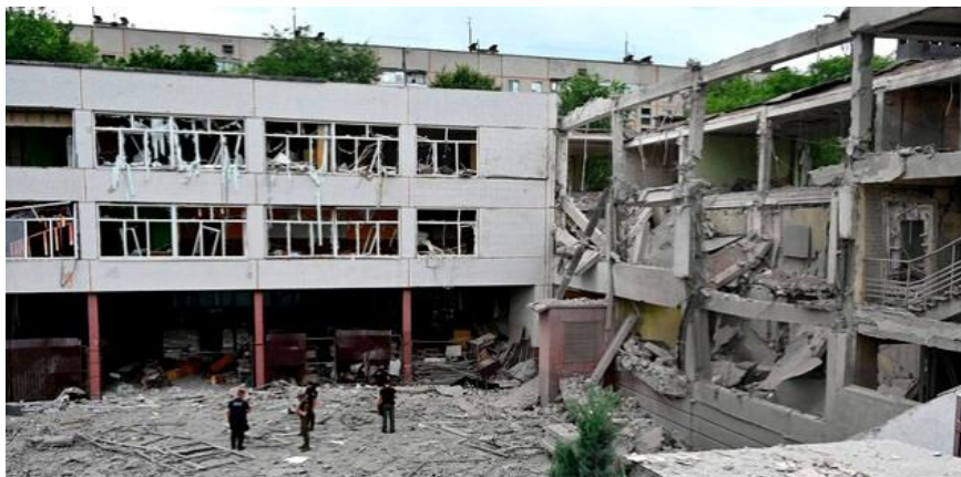
Рис. 5. Руйнування каркасно-панельної будівлі школи в результаті влучання російської ракети, м. Харків, 15 липня 2022 р.
