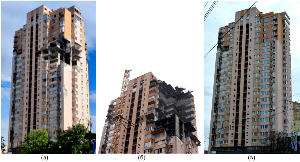
Рис. 6. Каркасно-монолітний житловий будинок, м. Київ: a – руйнування від влучання російської ракети 26 лютого 2022 р.; б – демонтаж конструкцій 17...26 поверхів; в – відновлений будинок
